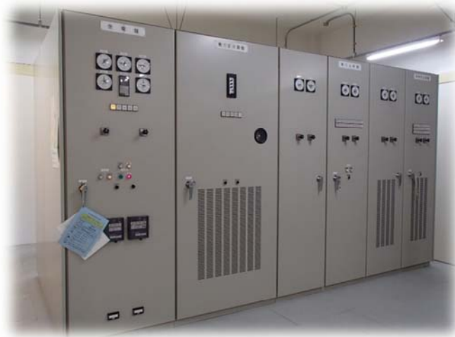
◆三国嵩浄水場 設備
