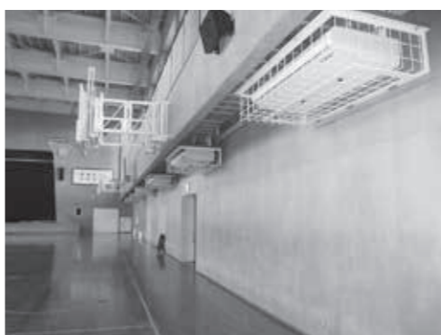
▲エアコンが設置された坂井中学校
