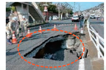
下水道管の老朽化による道路陥没事故
