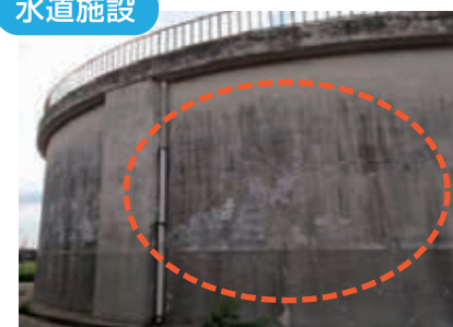
浄水場外壁のヒビ割れ
