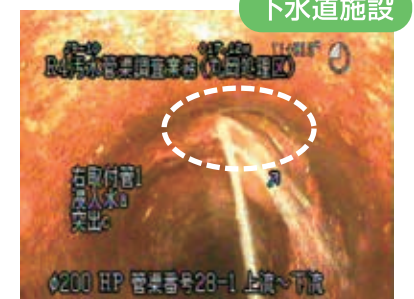
下水道管の老朽化によるヒビ割れからの浸水
