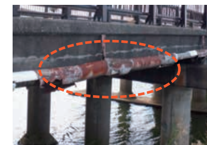
老朽化の進む水道管
