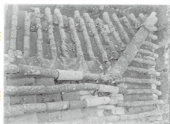
修理前の屋根【竹原写真】 石瓦の破損が随所に確認できます。
