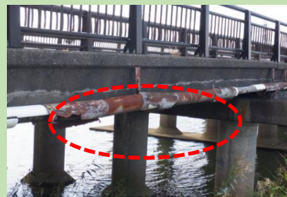
老朽化の進む水道管
