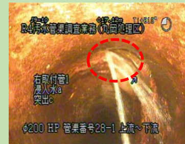
下水道管の老朽化による ひび割れからの浸水
