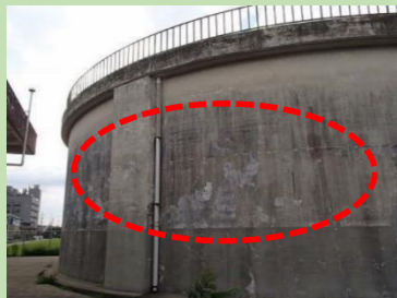
浄水場外壁のヒビ割れ
