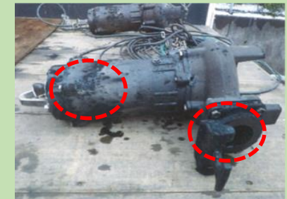
耐用年数を経過した マンホールポンプ
