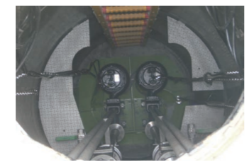
▲下水道施設(下水を送水するポンプ)に詰まっていたもの
