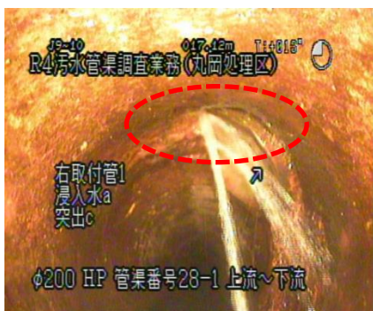
下水道管の老朽化による浸水
