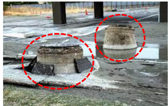
液状化現象によるマンホールの隆起
