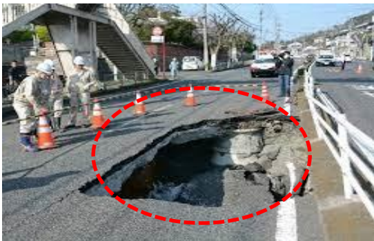
下水道の老朽化による道路陥没事故
