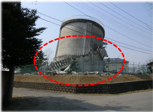
東日本大震災で破損した配水場
