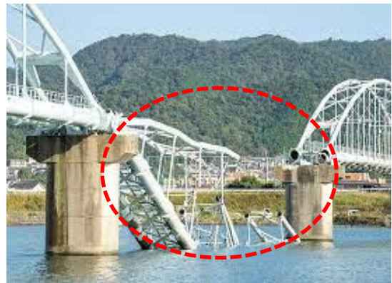
老朽化により倒壊した水管橋
