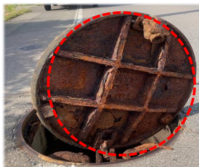
劣化したマンホール蓋
