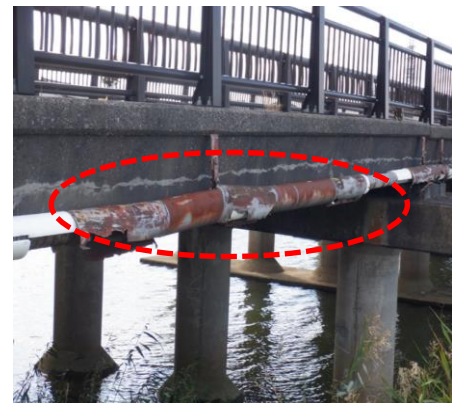
老朽化の進む水管橋
