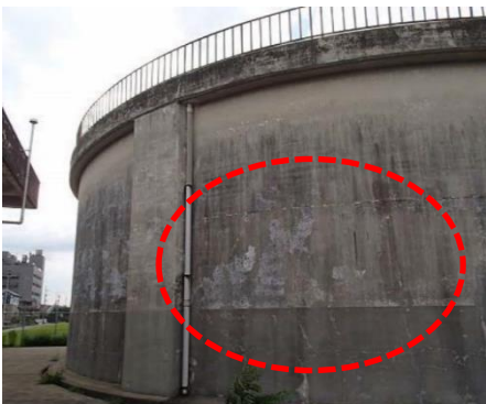
浄水場の側壁のヒビ
