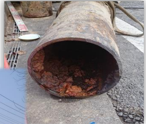
老朽管の状況
