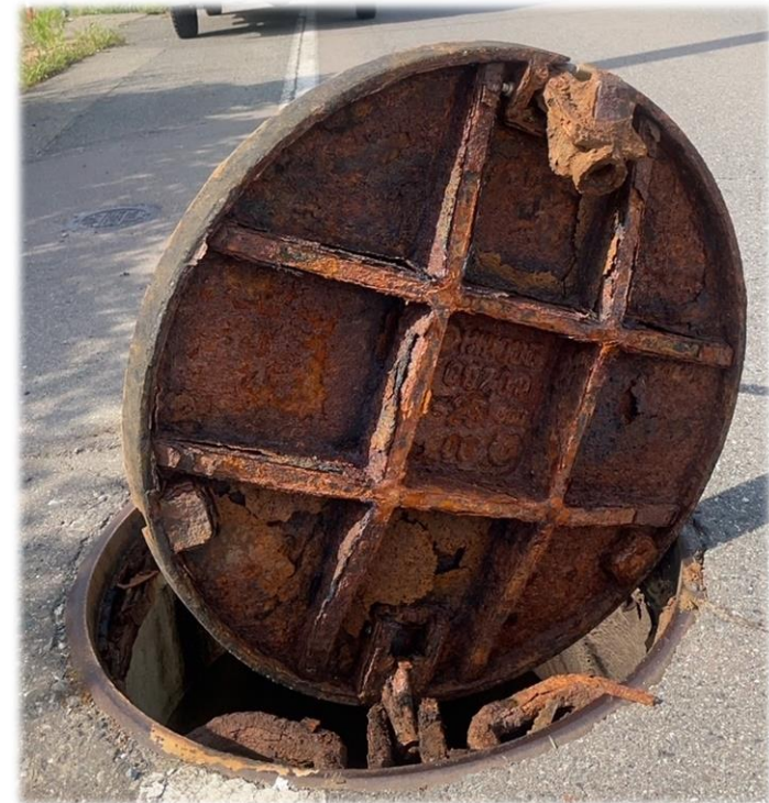
硫化水素により劣化したマンホール蓋
