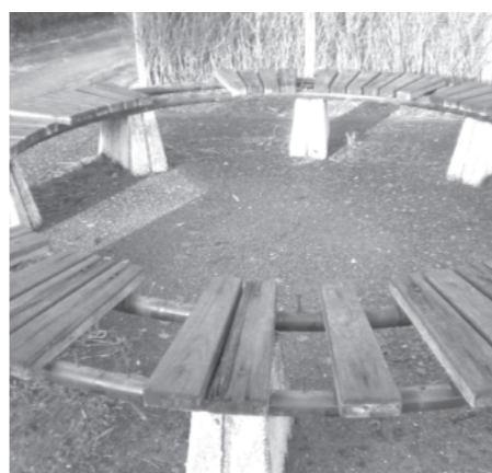
▲破損している公園遊具(パープルタウン公園)
