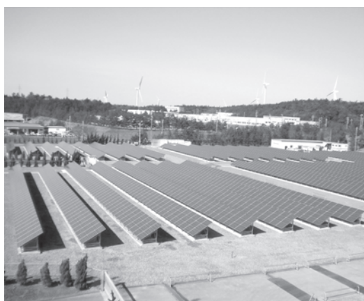
▲北陸電力 志賀太陽光発電所
