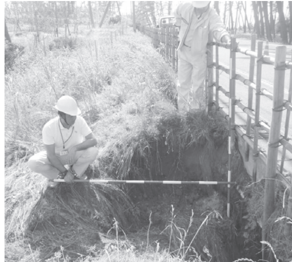
▲海浜自然公園の陥没
