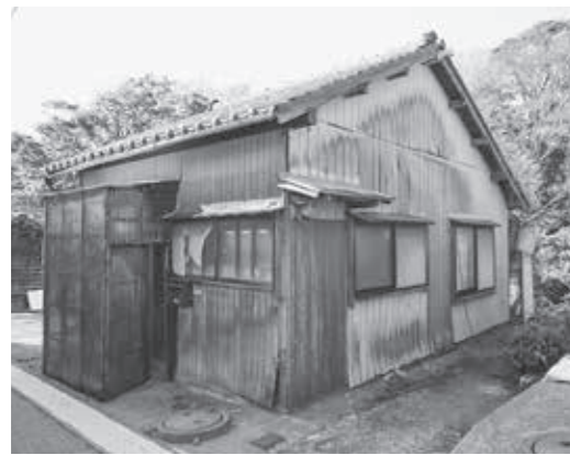
▲市内の老朽空き家
