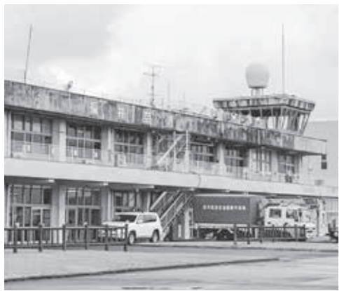
▲老朽化対策が望まれる福井空港ビル
