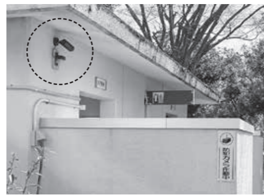
▲公園のトイレに設置された防犯カメラ
