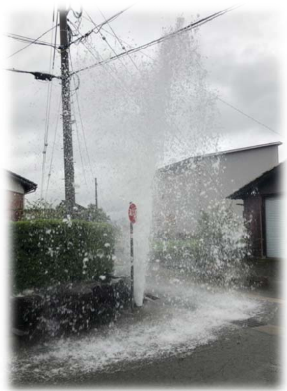
◆管路破損事故による漏水
