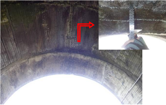
横断目地部の段差『Ⅱ』
