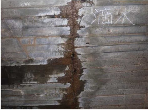
漏水：滴水『Ⅱ』
