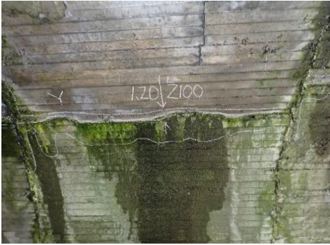
ひび割れ：前回より進行『Ⅱ』
