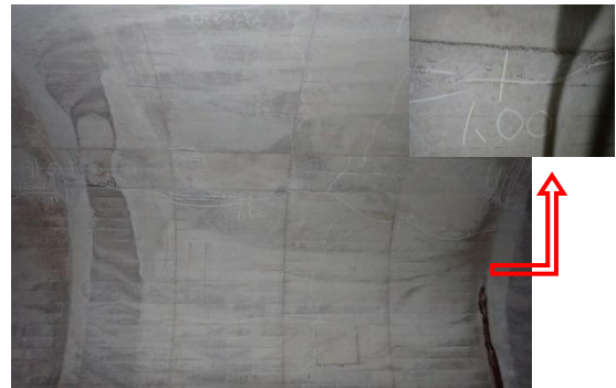
ひび割れ：前回より進行『Ⅱ』
