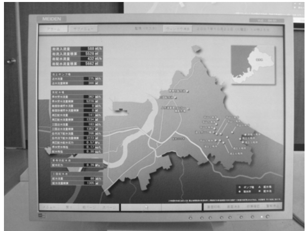
▲監視制御システム
