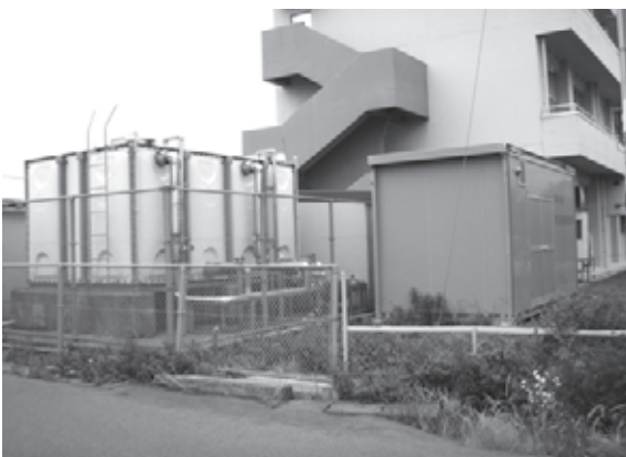
▲磯部小学校の防災備蓄倉庫と受水槽
