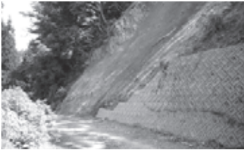
▲曾谷豊原線の土砂崩れ復旧状況
