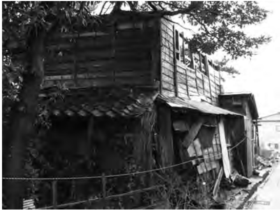
▲老朽化が著しい空き家
