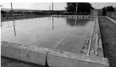
▲老朽化が懸念される市内小学校プール
