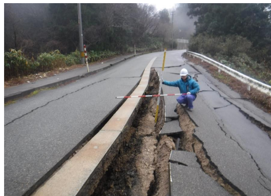
被災地の道路被害状況
